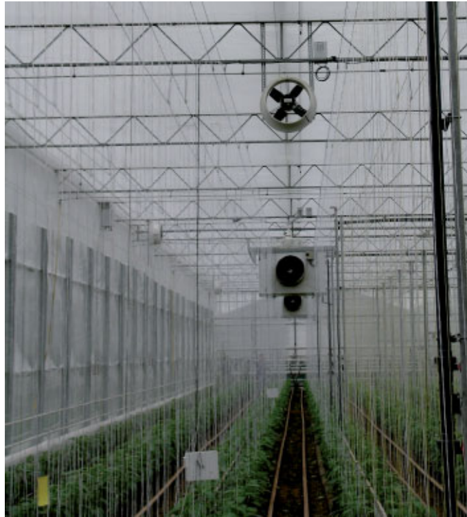
Figuur 7. Hulpventilator achter de LBK.
