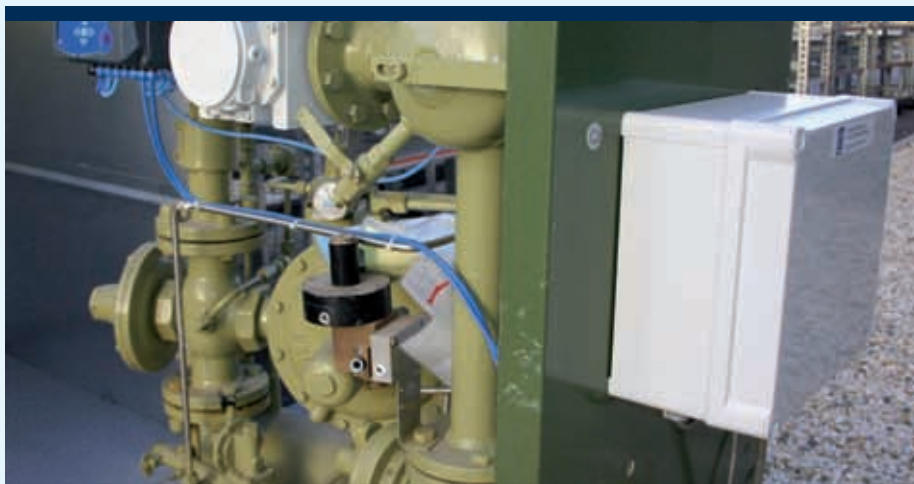
Door gebruik van speciale meetapparatuur is real-time het gas- en elektriciteitsverbruik van elk deelnemend bedrijf bekend.
