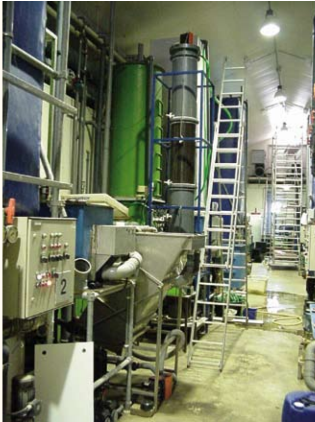
Linker kolom (groen): nitrificatiekolom, rechter kolom (zwart): voor denitrificatie.
