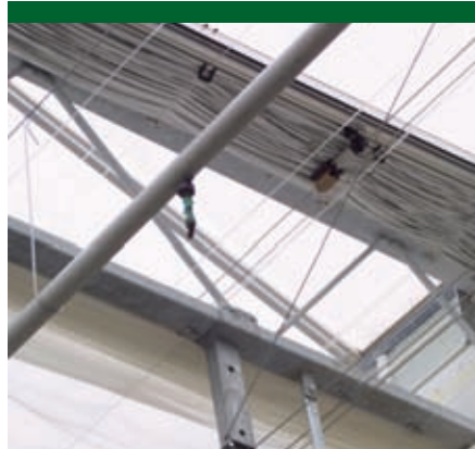
Bevestiging van schoordraden aan een stalen buis is niet ideaal. Door momentkrachten kan de buis breken of de tralieligger vervormen.
