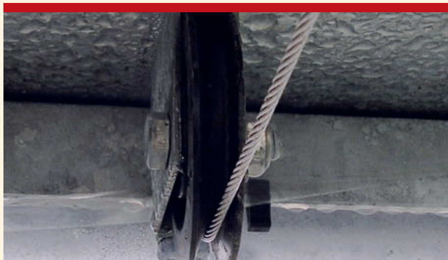
Vaak is het nodig om bij het installeren van een scherm extra voorzieningen aan te brengen onder andere bij de omkeerwielen in de kas.
