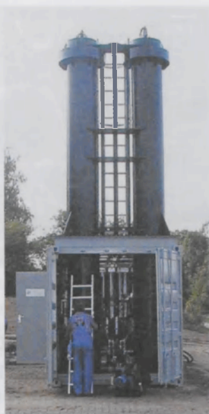
Figuur 2. Pilot-installatie rwzi Ede.
