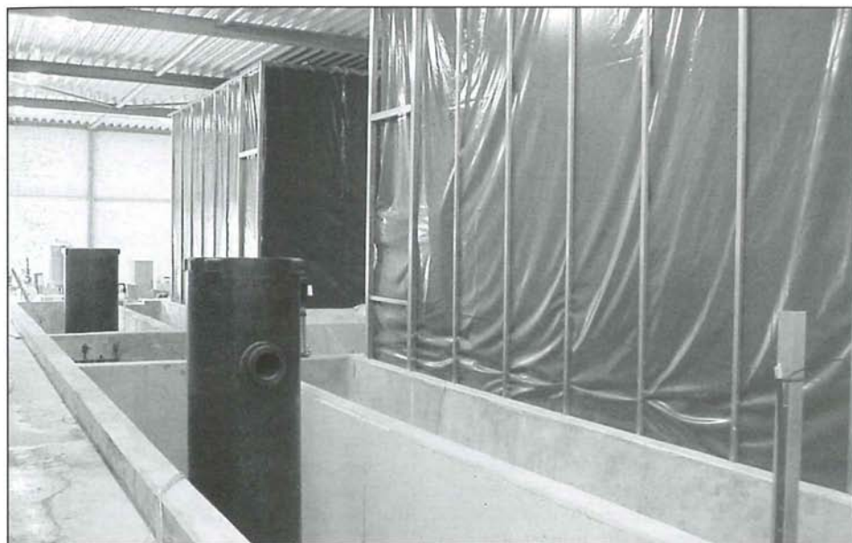
■ Tricklingfilters en zuurstofreactoren (verdiept aangebracht) in de 'machineruimte' naast de centrale 'vishal'.
