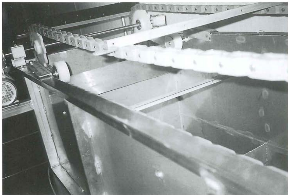
◆ Het schrapermechanisme van de flotatie-unit.
