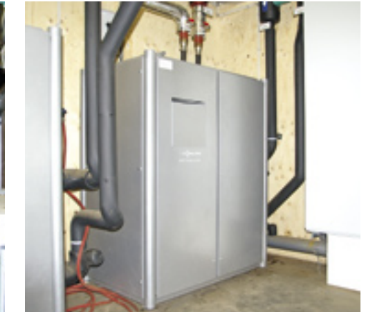
▲ De warmtepomp gaf tot nu toe een besparing van circa 60 procent van de gaskosten.
