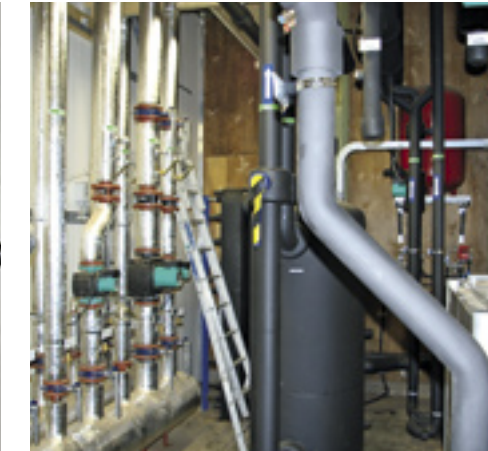
▲ Een warmtepomp kan zowel koelen (zwarte deel) als verwarmen (aluminium deel).
