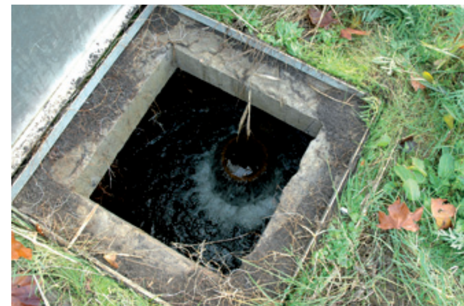
Het water dat door het rietveld is gezakt komt via buizen uit in een put en gaat dan naar het oppervlaktewater van de golfbaan. De vijvers op de baan zijn onderling met elkaar verbonden en vormen ook meteen een grote buffer voor de totale watervoorziening van de Efteling.
