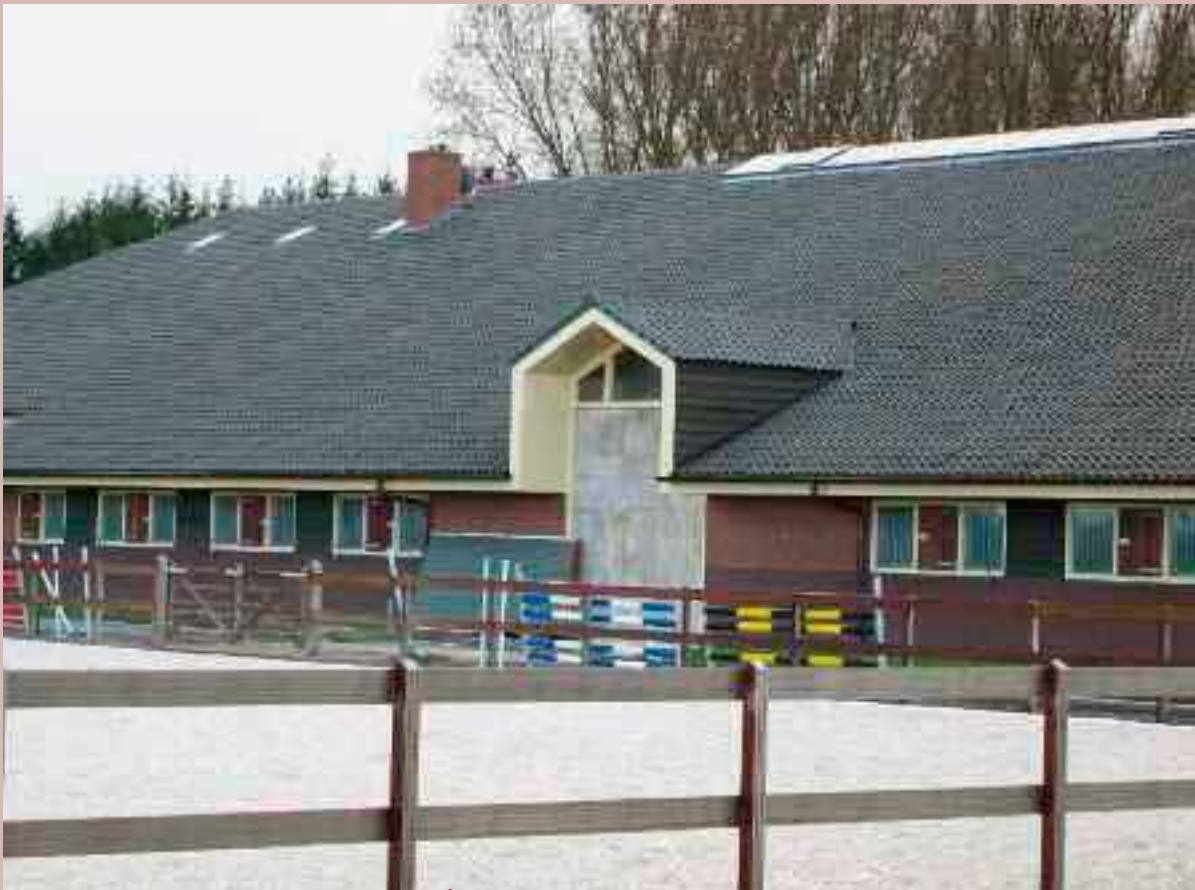
veel toevoegingen storen het dakvlak
