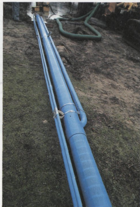
Foto 3 - Putconstructie (voordat deze in de ondergrond is gebracht) met de zuigleiding door de omstorting.
