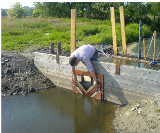
7) Het slootpeil kan naar believen worden gevarieerd door V-notch segmenten te verwijderen dan wel toe te voegen.
