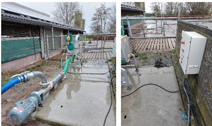
Foto 2 Pompinstallatie met rechts besturingskast.
