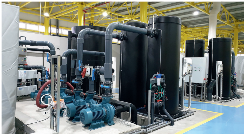
Onderdeel van het zuiveringssysteem van de RAS geïnstalleerd in Azerbeidjan door HESY (Foto Julian de Bondt).
