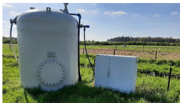
Afbeelding 2 Water voorraadtank en pompinstallatie.
