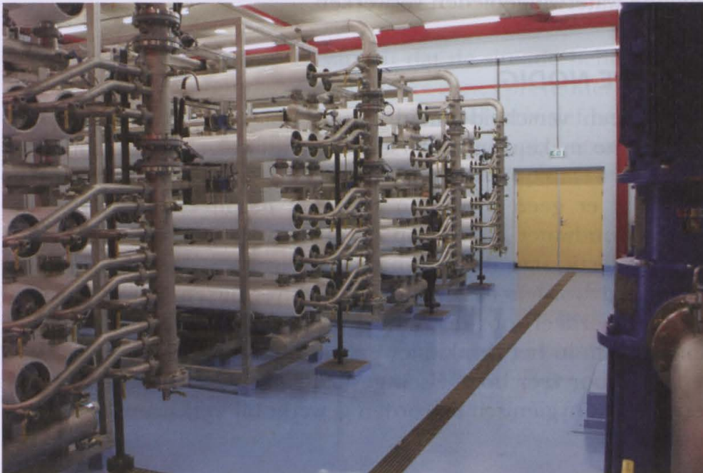
RO Dinxperlo, met 320 m 3 /h permeaat, op dit moment de grootste membraanfiltratie van Vitens.
