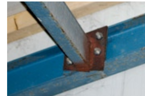
▲ Roestvorming door een te dunne verflaag.
