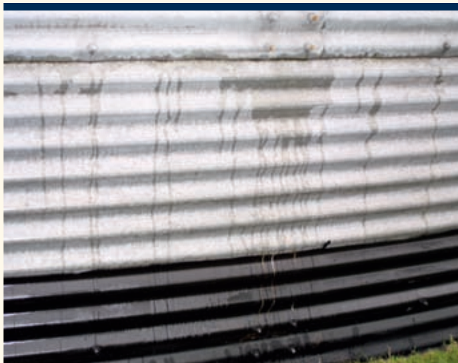
De watersporen midden op deze silo wijzen op lekkage. Er is direct een afspraak gemaakt met de teler om het probleem op te lossen.
