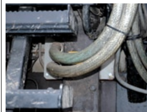
▲ De zware elektriciteitskabels duiden op de bijzondere aandrijving van de Eltrac.
