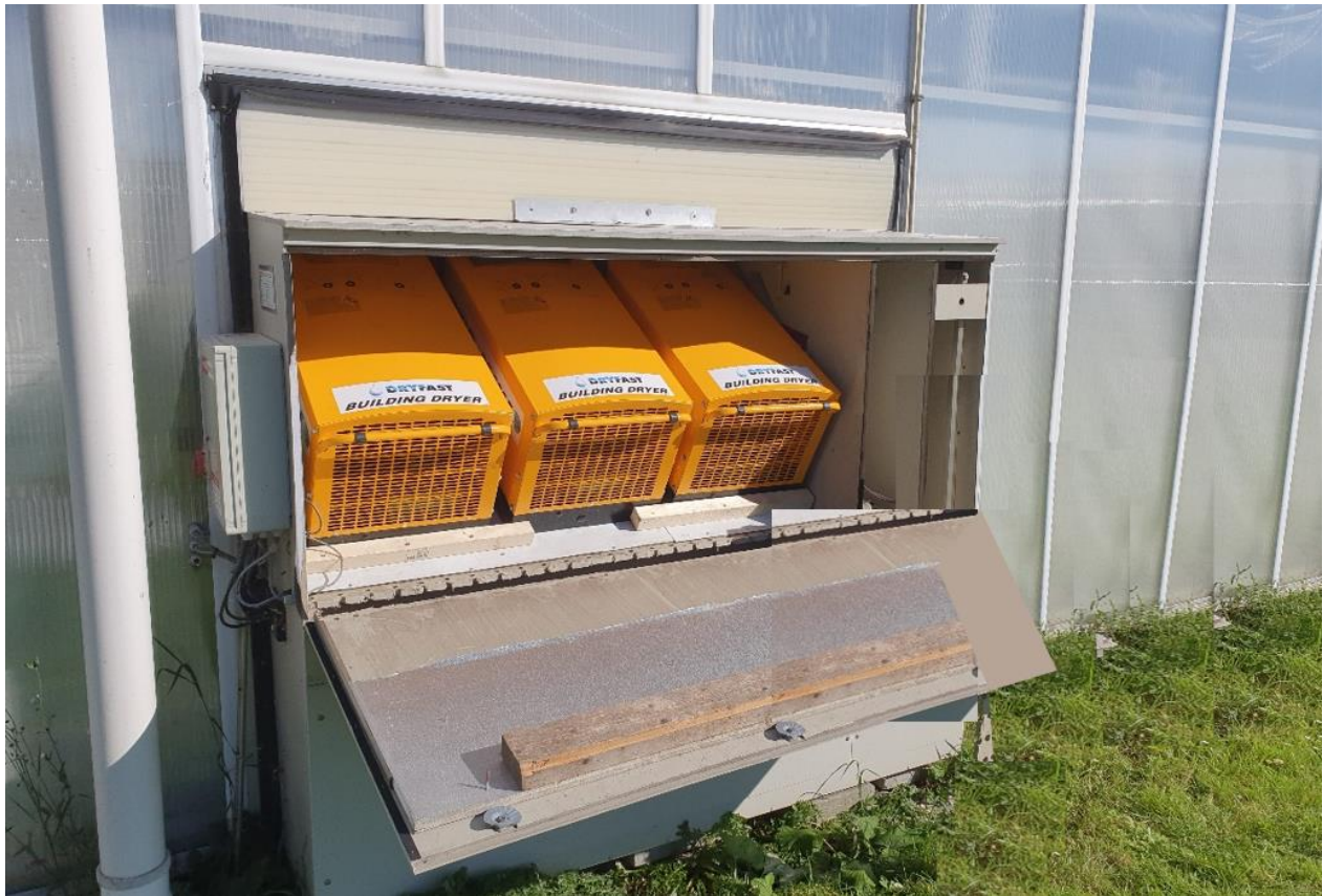
Figuur 2 De omgebouwde luchtbehandelingskast die na verwijdering van de lucht-lucht wisselaar die typisch is voor een balansventilatiesysteem met WTW plaats biedt aan 3 bouwdrogers.
