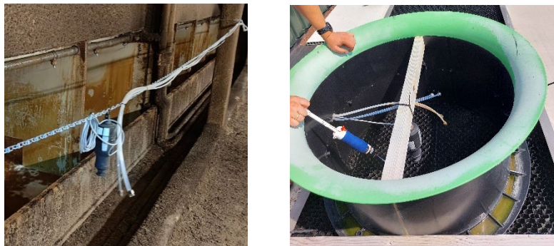
Figuur 2.2 Ammoniaksensoren in de ingaande ventilatielucht in de drukkamer voor de luchtwasser (links) en in de uitgaande lucht in een koker op het druppelvangpakket (rechts). Naast de sensoren zijn de PTFE-leidingen voor de luchtbemonsteringen te zien; 2 leidingen die voor de geurmetingen en 2 leidingen die voor referentiemetingen werden gebruikt. Rechts is ook een Kitagawa gasdetector te zien.
