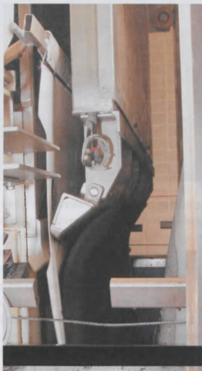
Lossen slib met geleideschrapers.
