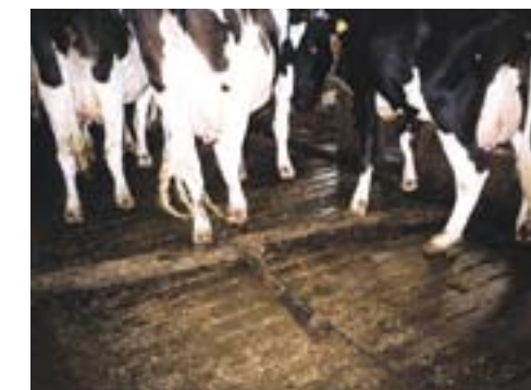
Uitgesteld onderhoud, in dit geval niet aanspannen van de kabel, zorgt ervoor dat de mestschuif scheef loopt. Door daarbij niet al te vaak te schuiven, blijft de vloer vuil.
