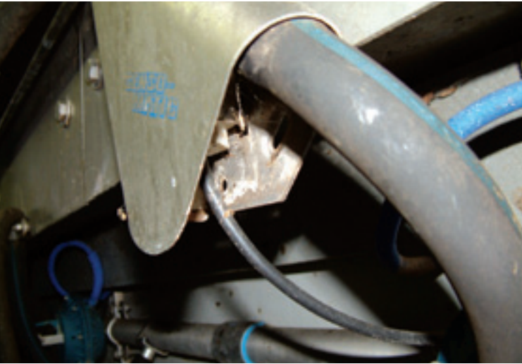
De doorstroommeter gaat schuil onder een rvs-kapje onder de putrand.
