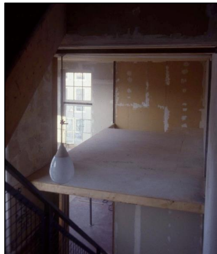
Figuur 10: De bouw van een insteekverdieping in De Wilde Wereld (archief WBVG)
