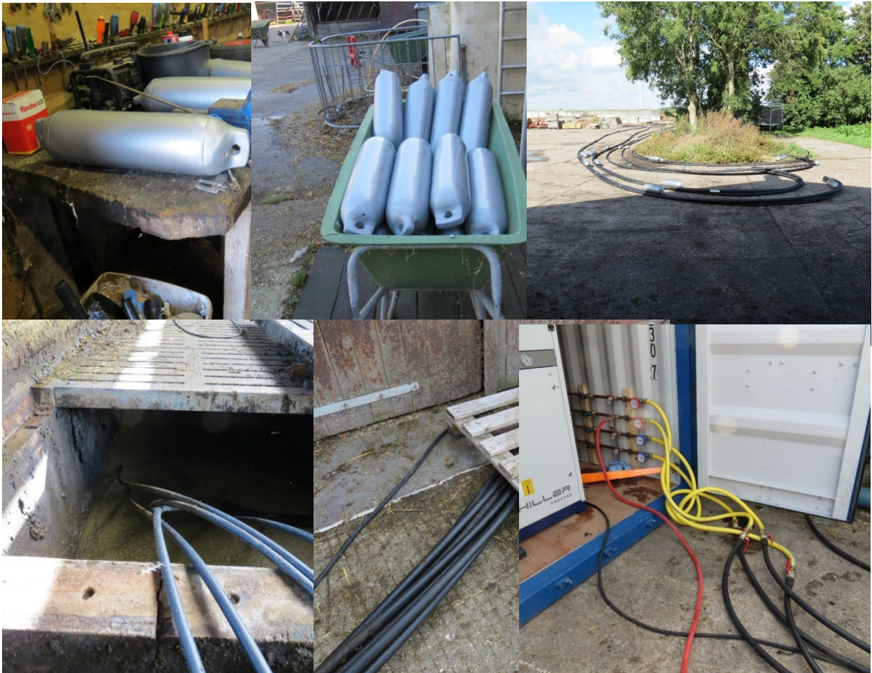
Foto 1 Mest koelen 2.0 (drijvende koelleidingen): gebruikte boeien (boven links en midden), koelleidingen met boeien voor plaatsing (rechtsboven), leidingen met koelvloeistof in mestkelder (beneden) en aansluiting aan koelunit (beneden rechts).
