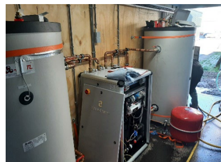
Foto 3 Impressie koelunit met o.a. warmtepomp en koude- en warmtebuffers.
