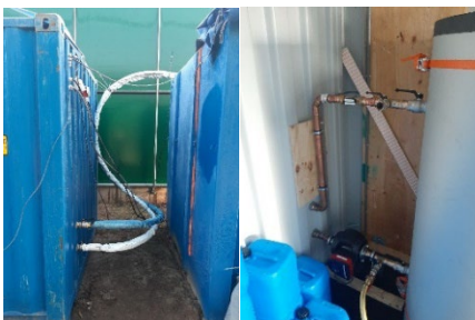
Foto 2 leidingen tussen mestcontainer (links) en koelunit (rechts).
