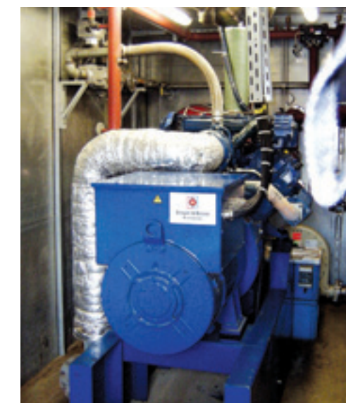
Het geproduceerde biogas moet een zo hoog mogelijke elektriciteitsproductie opleveren. Een grotere warmtekrachtkoppeling (WKK), ofwel de motor die het gas omzet in elektriciteit, heeft veelal een hoger rendement en lagere onderhoudskosten per kWh.
