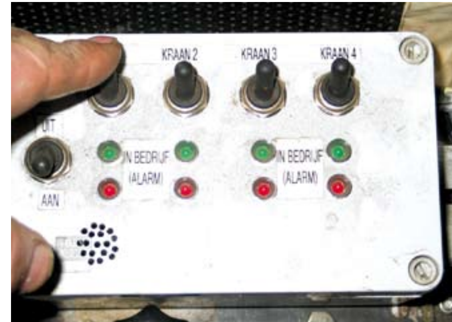
Vanuit de cabine zijn de vier injectiepomp in en uit te schakelen.
