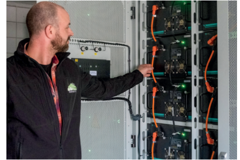
De batterijen slaan 190 kilowattuur op
