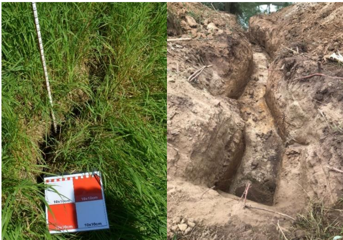
Figuur 3.4 Voorbeelden van scheurvorming bij droogte (links; bron: WDOD) en een bevergang (recht; bron: WSRL)
