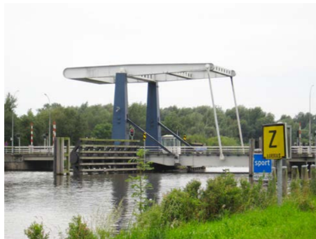
Figuur 12 De Borgbrug over het Eemskanaal. De brug heeft 3 doorgangen, waarbij alleen de middelste gebruikt wordt voor bootverkeer.
