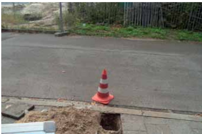
AFBEELDING 4: ASBESTGAT (FOTO: G. GISKUS, SIALTECH).
