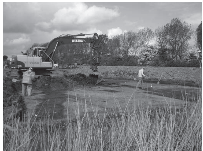
FOTO 2. OM IEDER BRONSTIJD-HUIS WORDEN HUISGREPPELS GEVONDEN. DEZE WAREN VOOR DE DRAINAGE VANAF HET DAK EN ALS ERFAFSCHIEDING.
