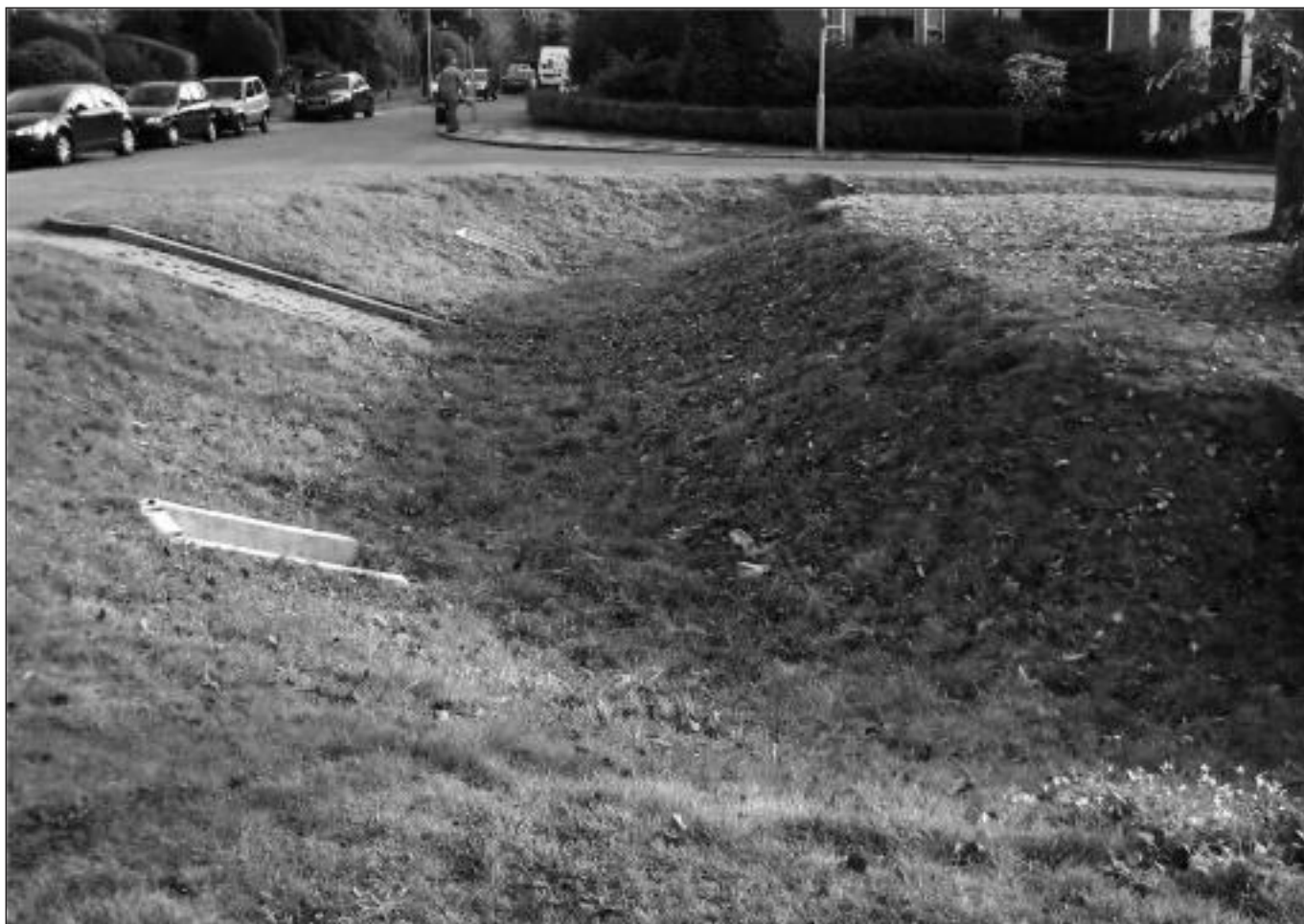
FOTO 2. WADI MET INFILTRATIEVOORZIENING.
