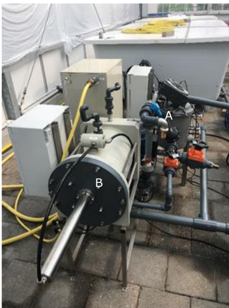
Figuur 2-1 Filterstraat 1 met filterstap 1 (A) en filterstap 2 (B).
