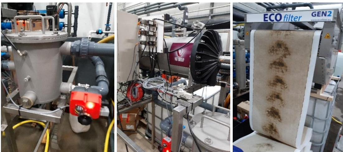
Figuur 2-5 Filterstraat bij Maarel Orchids. Van links naar rechts: gasfilter ( Fiber Filtration ), MT-IBA filter ( Fiber Filtration ) en papierbandfilter ( Ecofilter ).
