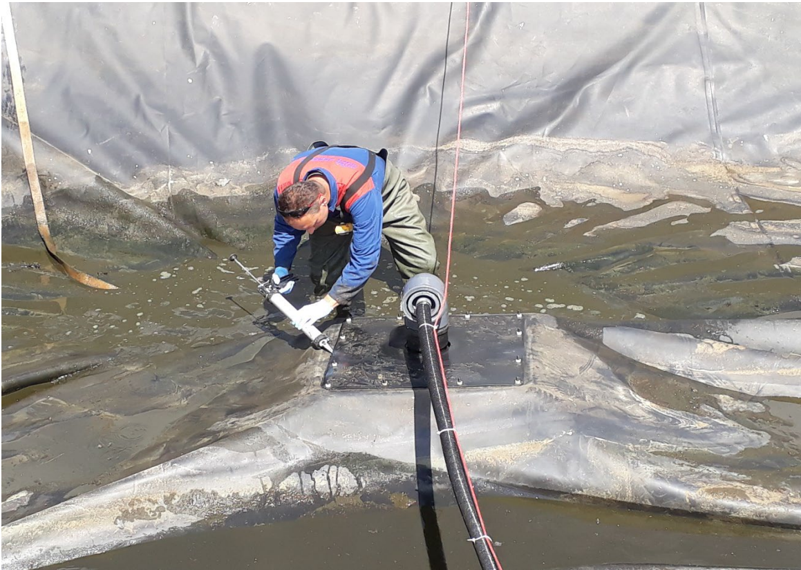
Figuur 14 Pogingen tot dichten van lekken van de bassin mestopslag.
