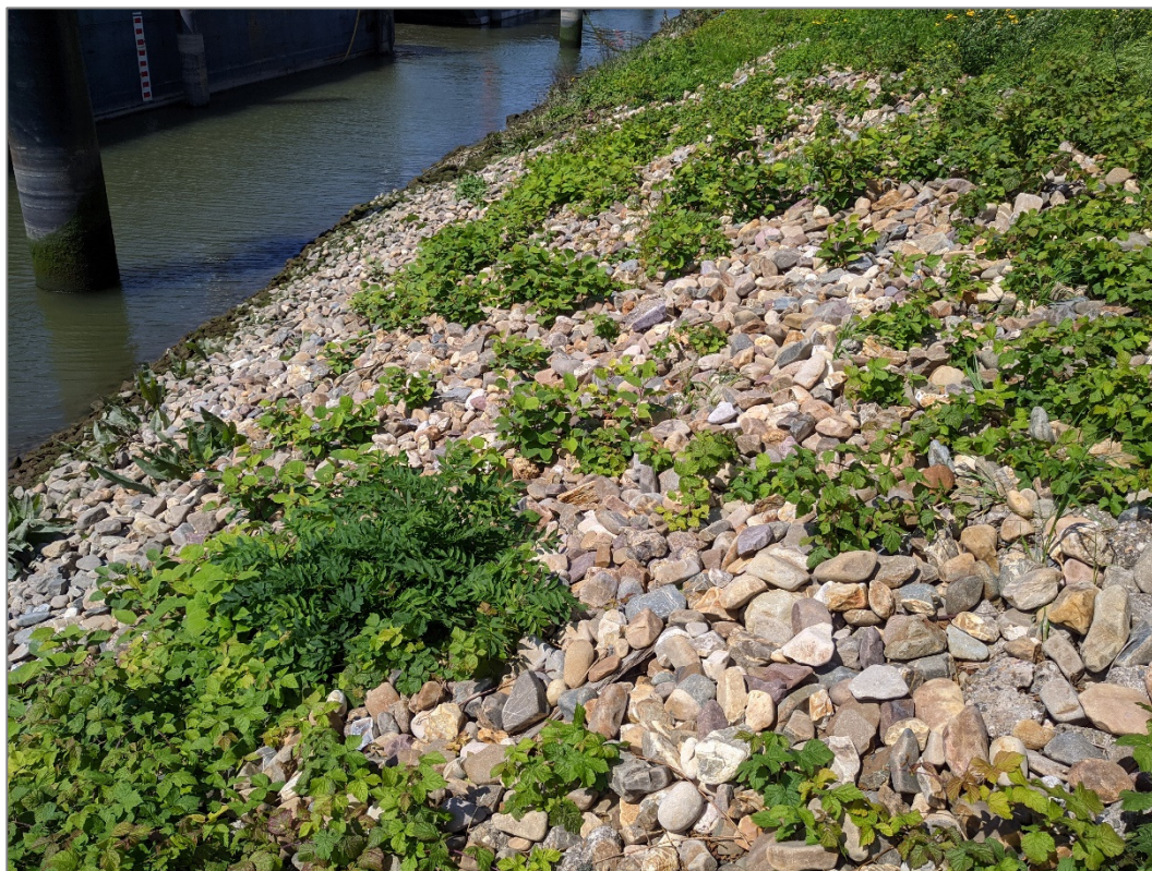
Figuur 17. JDK-081 aan de Quarantaineweg, geëgaliseerd met maaskeien, situatie op 8 augustus. De transportbanden zijn nog niet aangebracht en de duizendknoop groeit tussen de keien omhoog.
