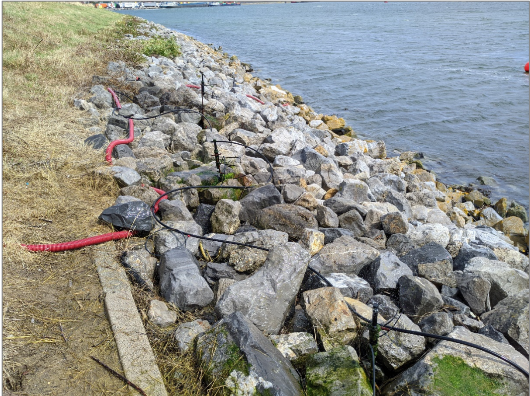
Figuur 12. Sprei-druppelinstallatie in de steenglooiing van JDK-020 Dintelkop.
