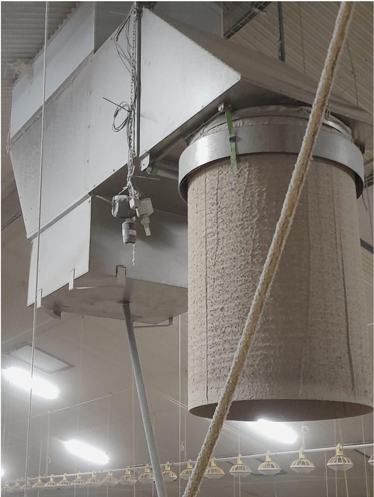
Granovi warmtewisselaar en locatie sensoren
