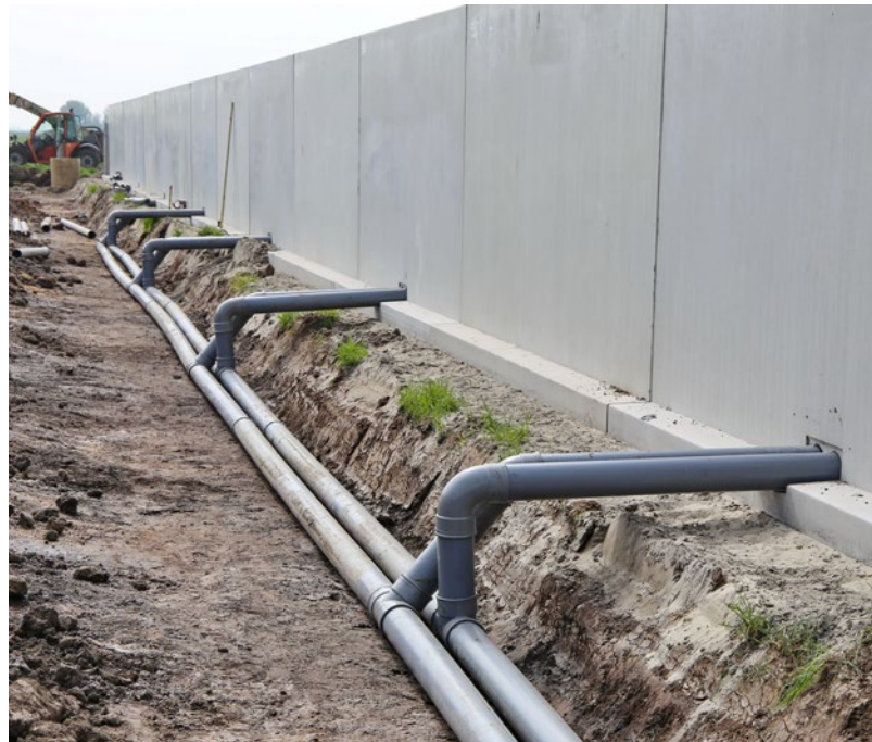
Figuur 1. Aanleg van afvoer van een duogoot. Deze voert perssap af naar een opslag en neerslag naar het oppervlaktewater.
