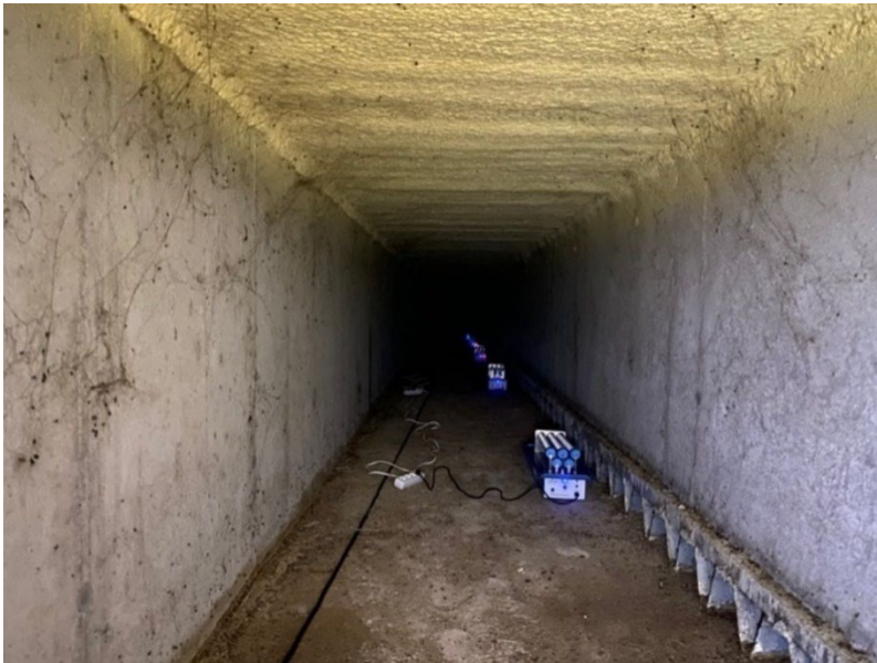
Figuur B2.2 Ionisatiesysteem in het luchtkanaal (© Faton).
