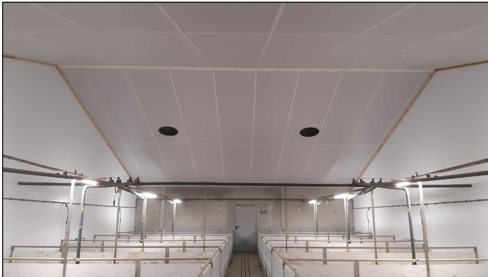
Figuur B1.4 Plafond van de afdeling met twee ventilatiekokers naar het centrale ventilatiekanaal.
