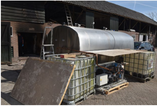
Afbeelding 8: Gerealiseerde noodvoorziening melktank met koeling op het erf.
