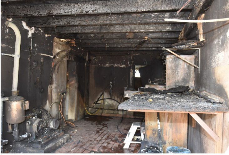
Afbeelding 5: Technische ruimte gezien vanaf de deuropening
