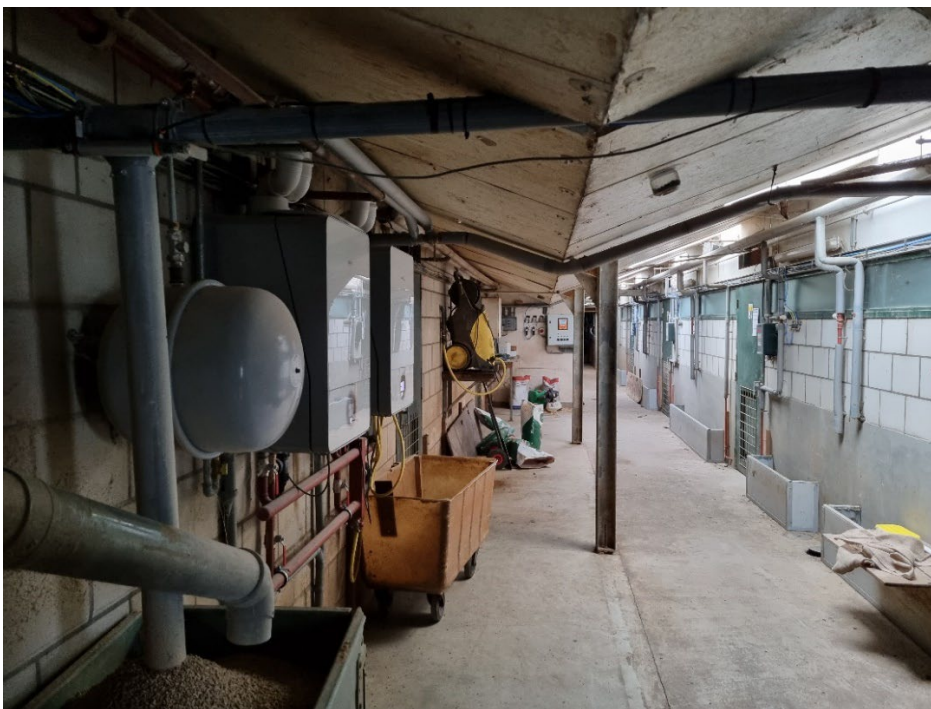
Figuur 3.2 Apparaten in de centrale gang op een varkenshouderij.
