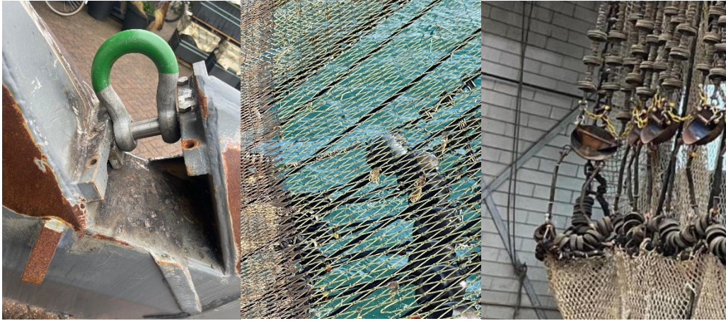
Figuur 46. Links, Nieuwe ophangpunten wekker waterspraywing, midden & rechts: buitenste bolkop die niet goed hangt en verwijderd is gedurende de week.
