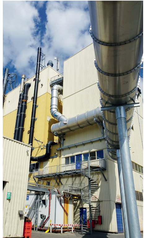
Foto 12: Grote buis waardoor de lucht uit fabriek naar luchtfilter wordt gepompt.
