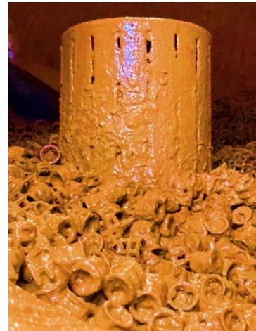
Afbeelding 2. IJzer- en biomassa-ophoping in pallringen en beluchtingspyloon van een beluchtungs- en ontgassingstoren op PS Breehei
