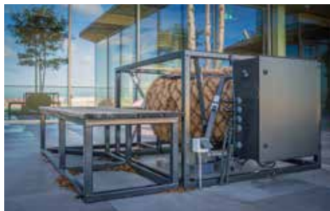
Technische opstelling van een boomveer op kantoorgebouw The Finch, Oegstgeest
