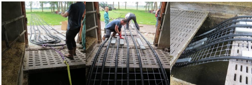
Foto 2 Impressie van het geïnstalleerde leidingsysteem op B1.
