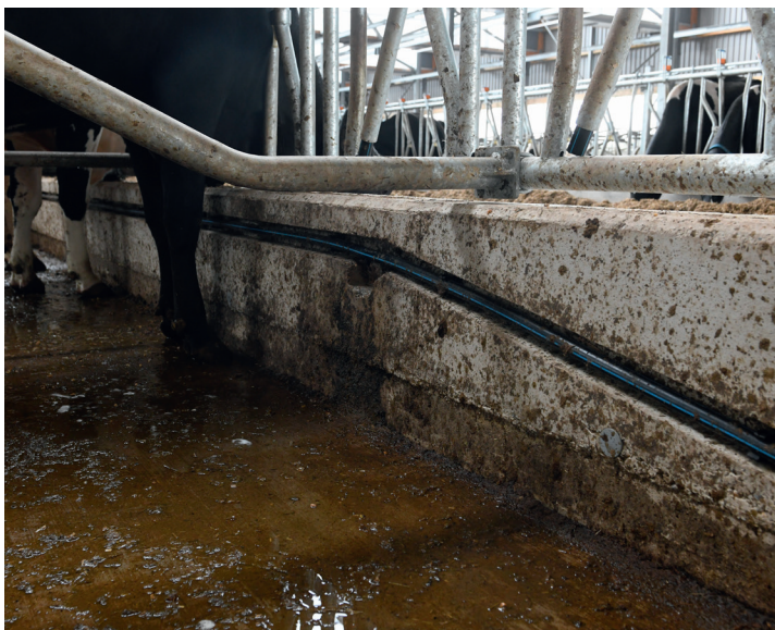
De gietasfalt vloer wordt regelmatig besproeid met water en een middel dat het enzym urease remt en daarmee ammoniakvorming voorkomt
