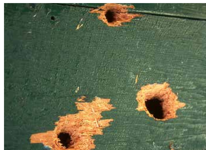
Spechtenschade aan zijkant broedkamer. Foto Henk van der Scheer
