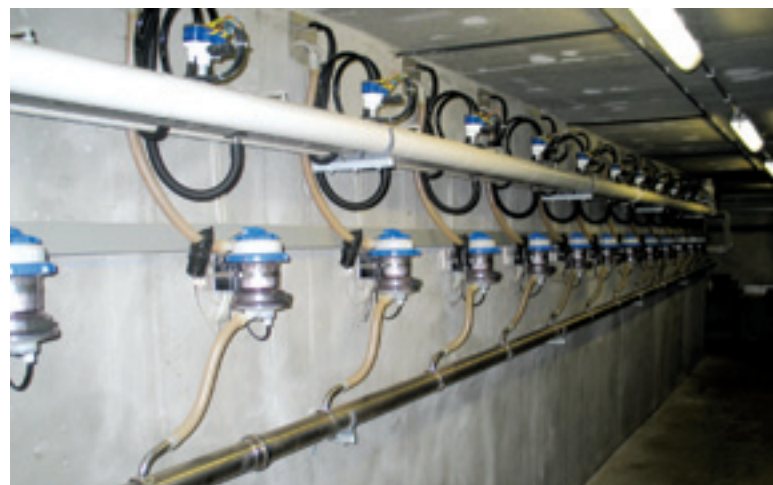
In de kelder is alle ruimte om pulsatoren en leidingen weg te werken.
