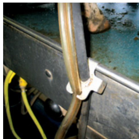
Een simpele geleideklauw zorgt ervoor dat de leidingen niet onder spanning komen te staan.
